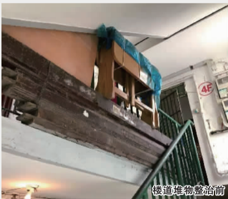
楼道堆物整治前
