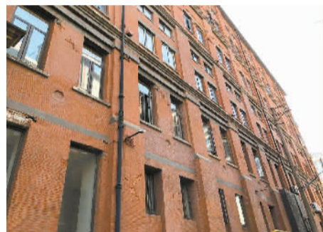
建筑外体裂痕清晰可见
