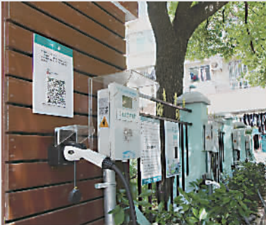
仙霞小区电动汽车充电站
