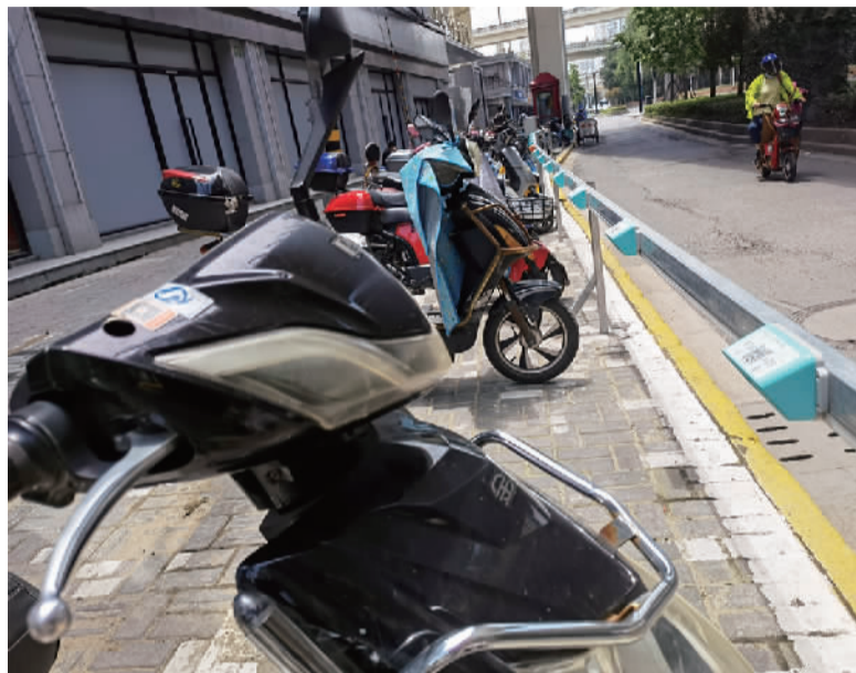
中山北路沿街建成待投入使用的智能充电桩
